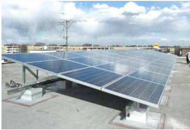
約10kW 4段12列横置10°
