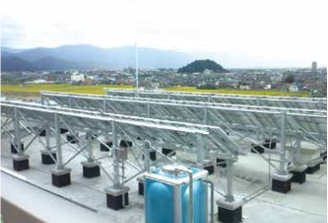
約30kW 2段22列横置35°
