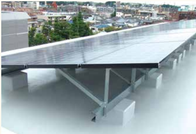
約8kW 4段11列横置10°
