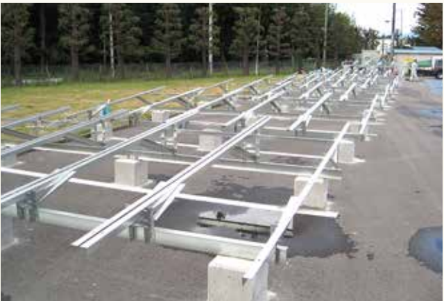
約23kW 3段5列縦置5°
