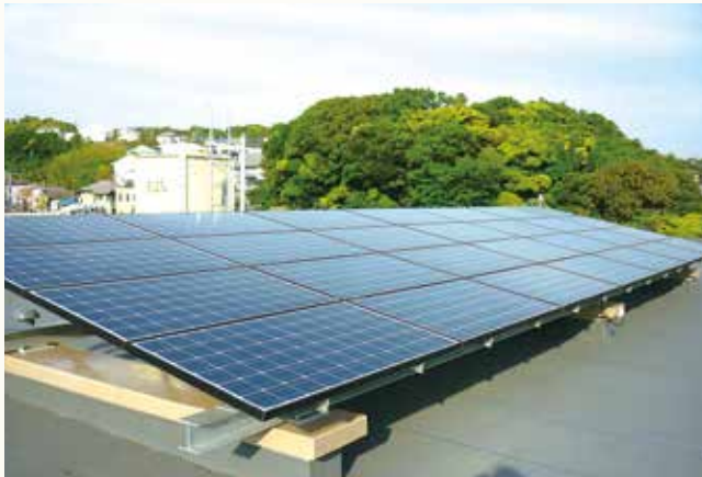
約6kW 4段7列横置10°
