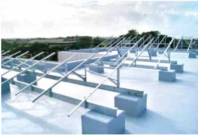
約10kW 3段2列横置20°、2段5列横置20°、4段6列横置20°
