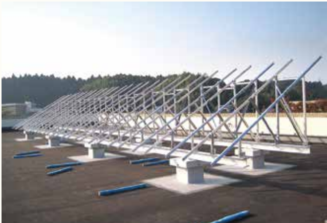
約10kW 4段14列横置30°
