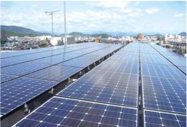
約27kW 4段12列横置、3段12列横置、5段4列横置、5段2列横置5°
