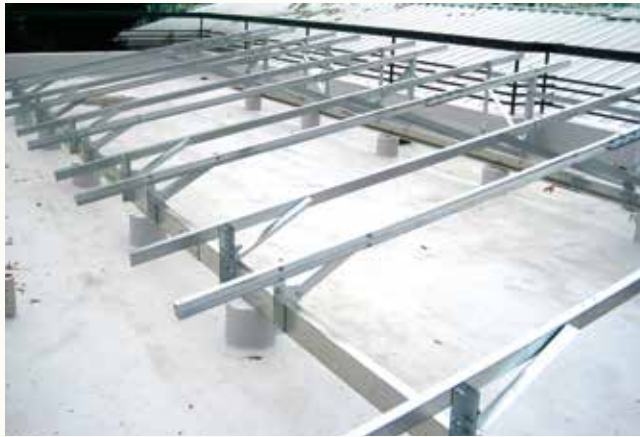
約5kW 4段6列横置10°
