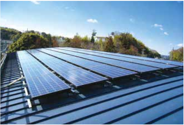
約20kW 6段9列横置0°、9段6列横置0°
