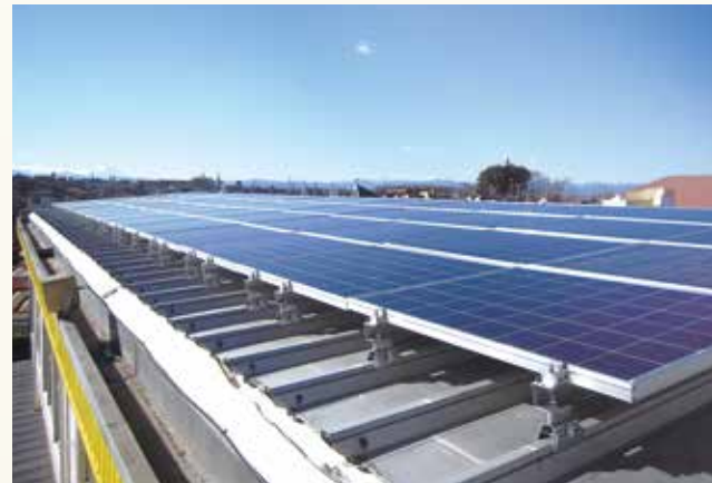
約10kW 4段14列横置0°
