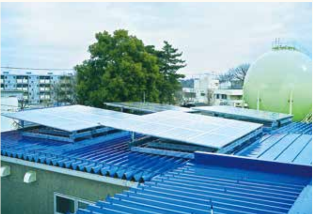
約10kW 4段3列横置5°
