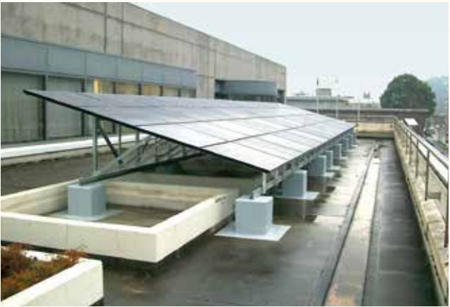
約10kW 4段14列縦置10°
