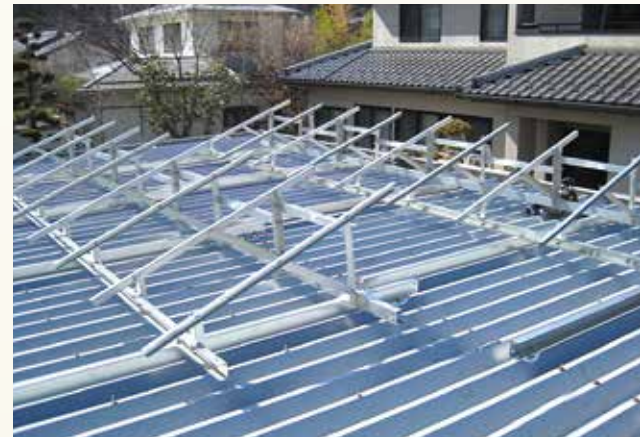
約4kW 2段4列横置20°、2段5列横置20°
