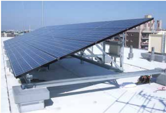
約5kW 4段7列横置20°
