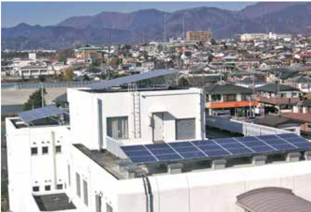
約15kW 3段8列横置10°、4段6列横置10°、7段4列横置10°
